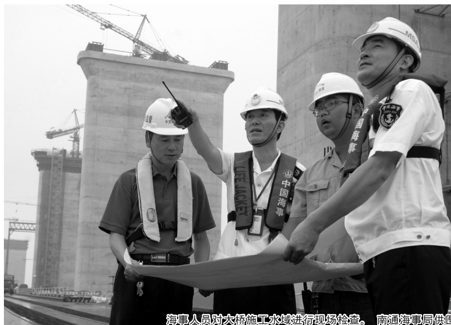
海事人员对大桥施工水域进行现场检查。南通海事局供图
